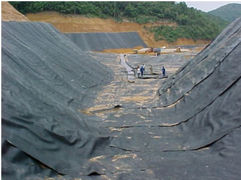
Manta de PEAD (Polietileno de Alta Densidade) para impermeabilização do solo (reveste todo o Aterro Sanitário)
